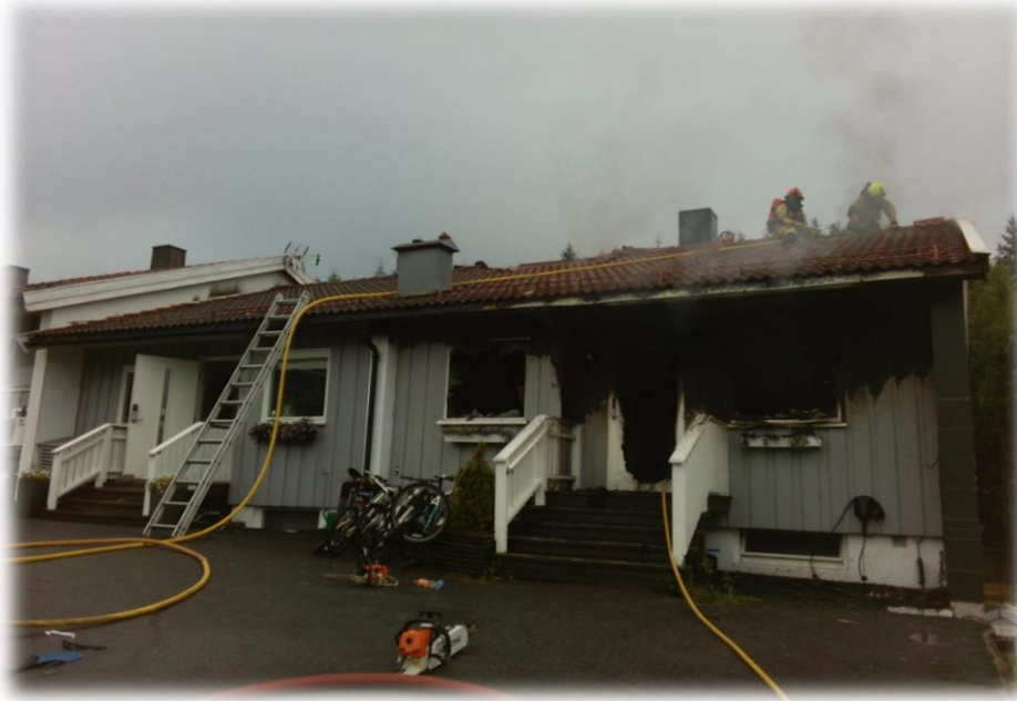
Figur 7 Legg merke til nabo leilighet, der var det kun minimalt med røyk og vannskader, godt utført slokkeinnsats av brannvesenet.
