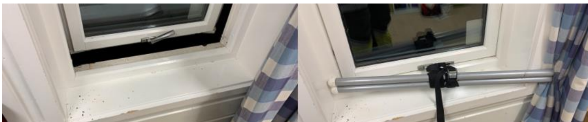
Fra et innbrudd i en barnehage, hvor vinduet er sikret provisorisk i ettertid – kreative løsninger må til.
